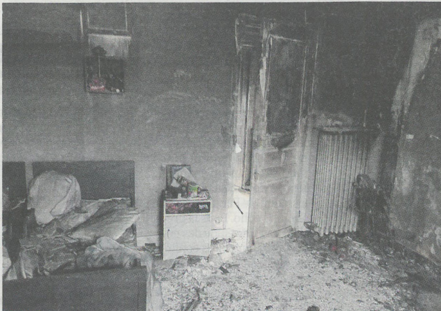
Corbeil-Essonnes (Essonne), hier. Le feu serait parti du compteur Linky qui se trouvait dans l'angle au-dessus du radiateur, dans la chambre des jumelles de David.
