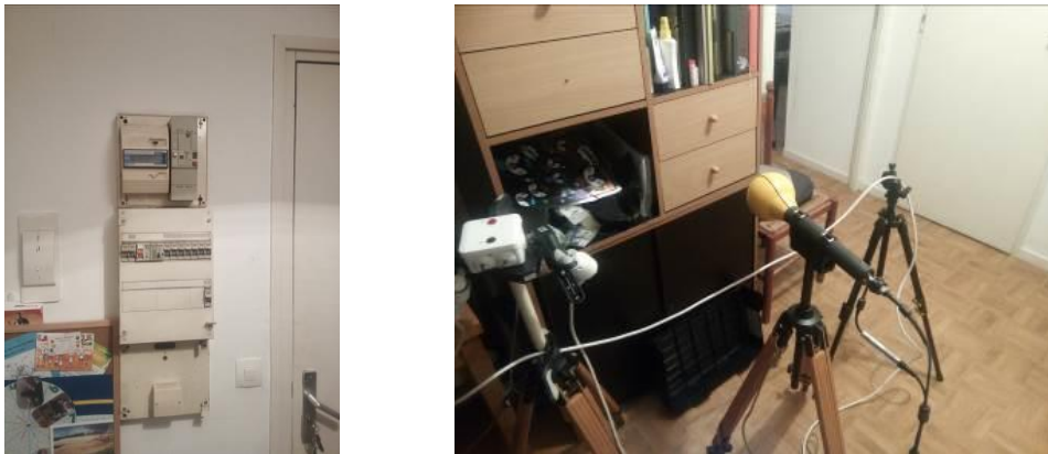
Figure 4-6: le tableau électrique avec l'ancien compteur (à gauche) - mesures de courant électrique CPL Linky et de champ magnétique rayonné dans l'entrée devant le tableau électrique (à droite)
