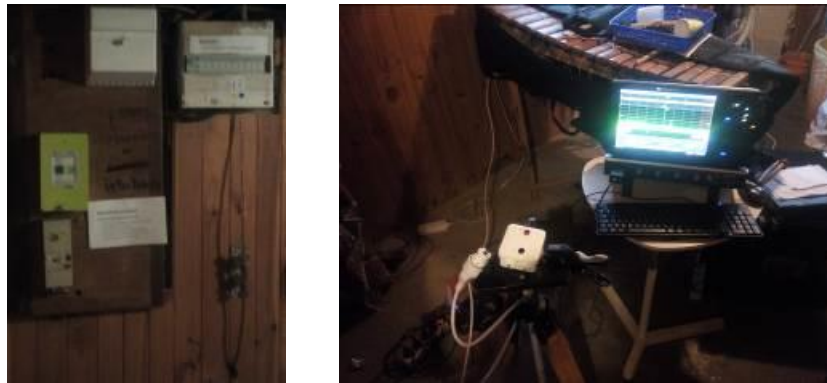
Figure 4-1: le tableau électrique avec un compteur Linky G1 et la mesure de courant CPL
